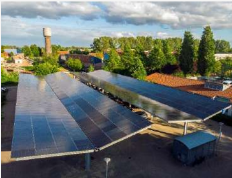
Marquesina solar para coches que genera electricidad renovable y sirve para cargar coches eléctricos (© Amar Sjauw En Wa)
